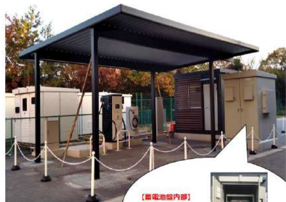
【蓄電池室内部】 日産リーフ 再生バッテリー搭載
